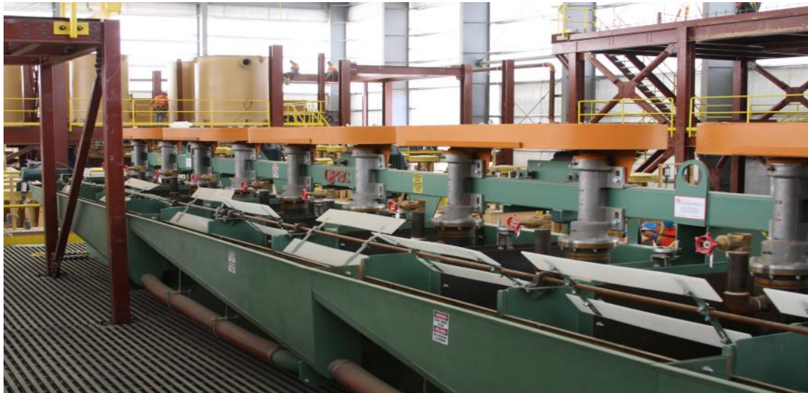
10 Bancos de Celdas 2 ea QPEC de No. 18 Spl Maquinas de Flotación
